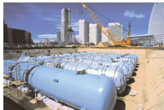
写真2 貯水槽の設置例（みなとみらい21地区）
